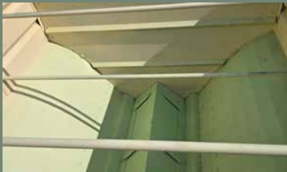
Separación interior // Interior separation
