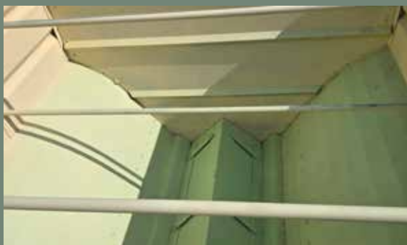
Separación interior // Interior separation
